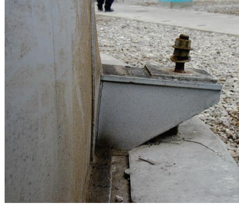
איור 1-6.4.2.2 - כשל בחיבורי בסיס של מיכל דלק (5000 מ"ק).
