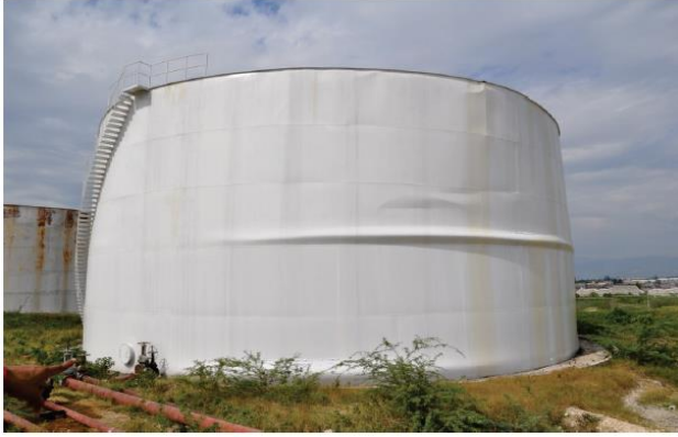
איור 3-6.4.2.2 - כשל בדופן מיכל.
