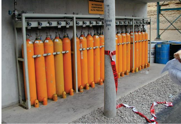
איור 2-6.4.2.3 – בלוני גז מעוגנים שנותרו ללא פגע לאחר רעידה.
