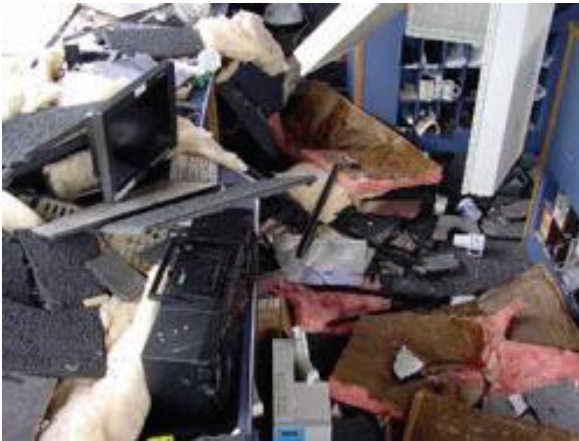
איור 6.5.3.3-2 – נזק בחדר בקרה בשדה תעופה.
