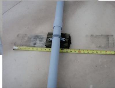
איור 6.4.3.6-2 – צינור לא מעוגן לגג, החזות של כ-30 ס"מ ברעידה.
