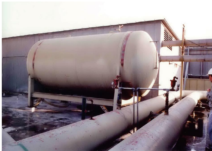
איור 3-6.4.2.1 – מיכל אופקי הנשען על מסגרת בגג בית חולים, אחת מהרצועות נכשלה והמיכל זז כ-15 ס"מ.
