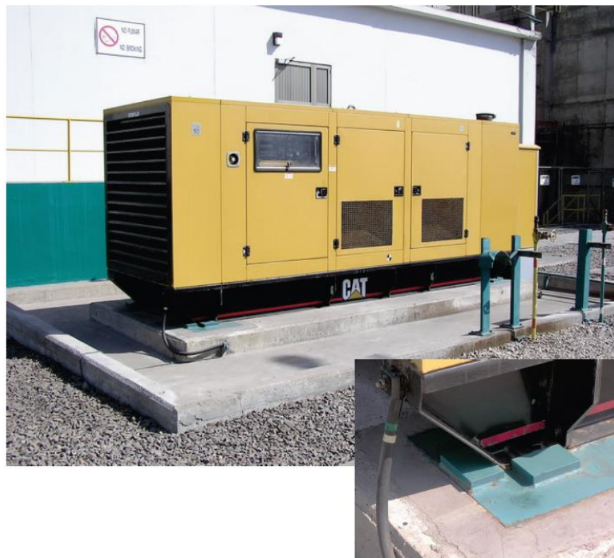
איור 2-6.4.7.2 – גנרטור חירום עם תושבת החלקה ממוקם על משטח פלטת בטון. הותקנו "Shear Lugs" לאחר התרחשות רעידת אדמה.
