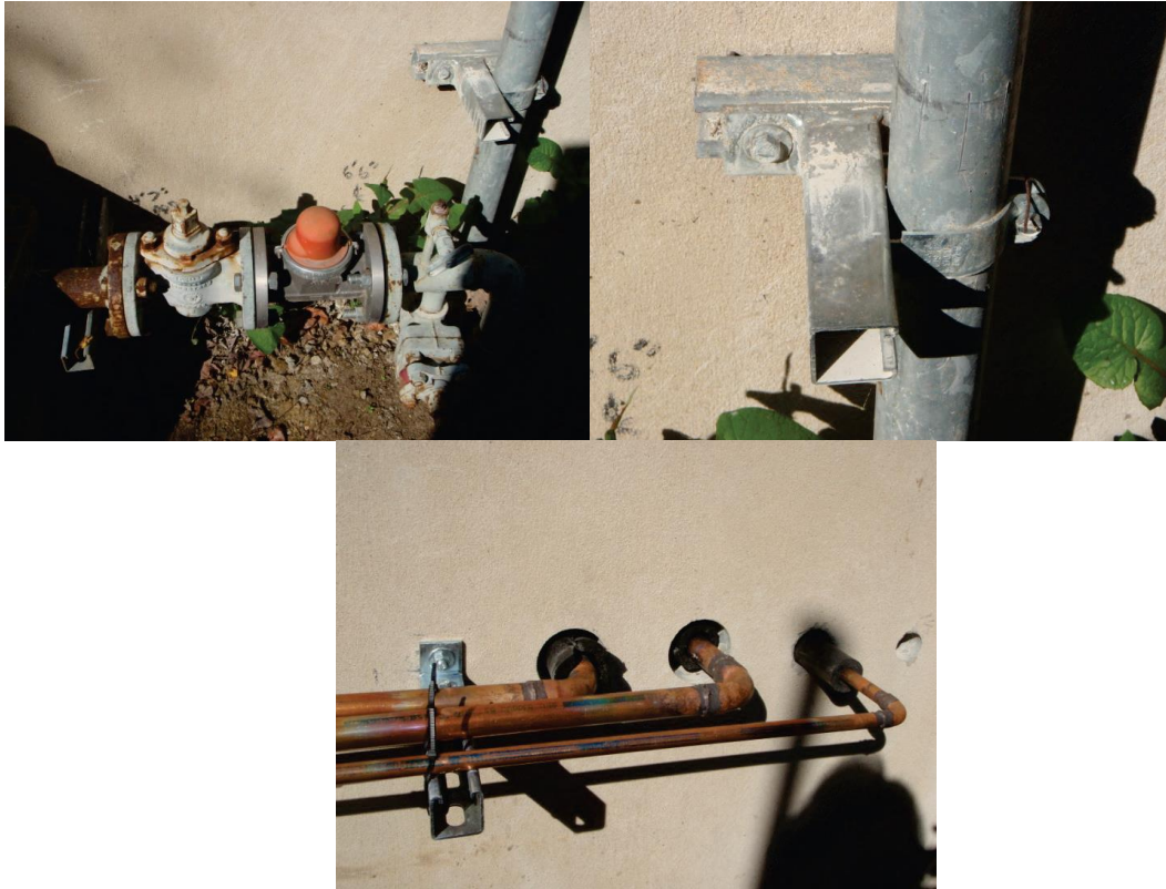
איור 3-6.4.3.7 – דוגמא לתמיכות וחיבורים טיפוסיים לעיגון צנרת בקיר. בתמונה התחתונה הרכבת העיגון נמצאת בתהליך והצנרת מחוברת לקיר בחיבורי פלסטיק באופן זמני.
