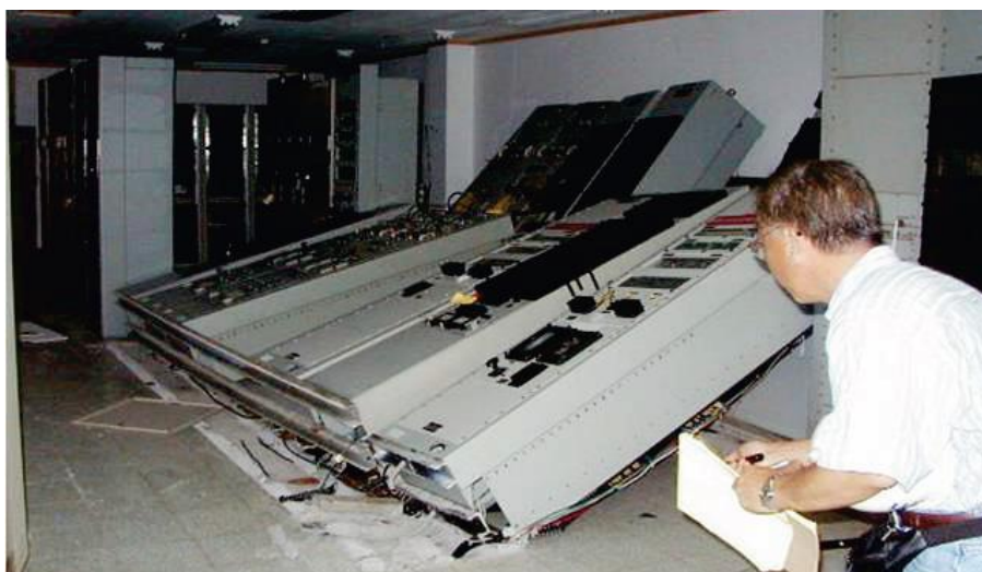
איור 1-6.4.7.1 - התהפכות ארונות חשמל. שימו לב למחסור בעיגון הארונות לרצפה.
