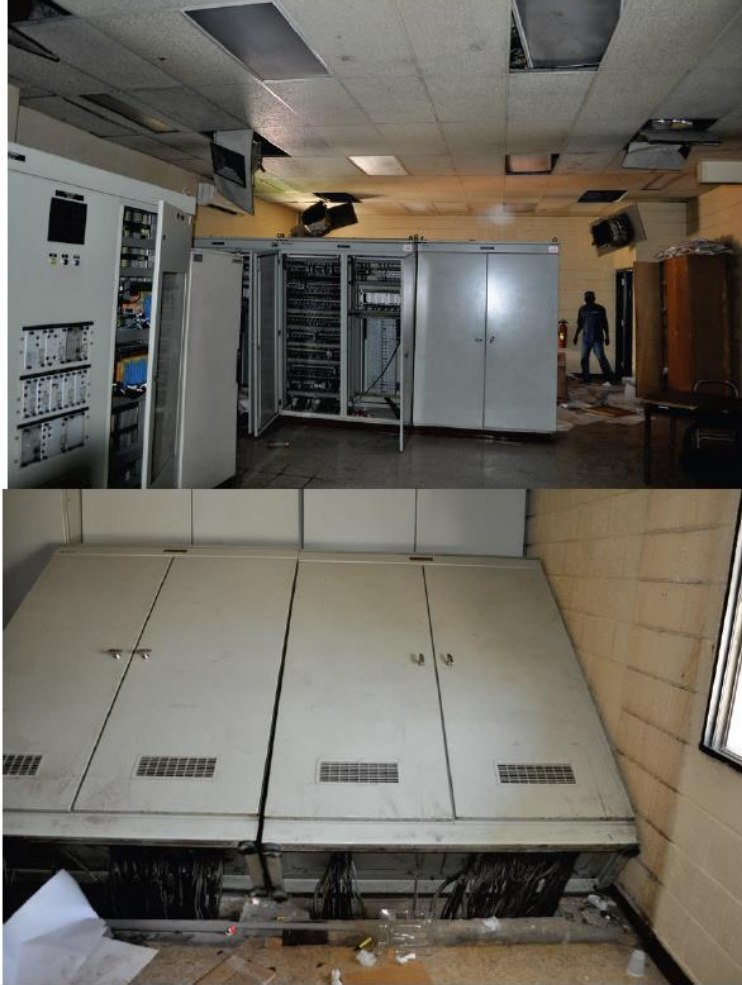
איור 3-1.6.4.7 – נזק שנגרם לארונות חשמל לא מעוגנים בתחנת כוח.
