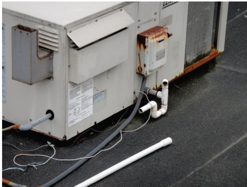
איור 6.4.3.6-2 – כשל בחיבור צינור לא מעוגן על גג.
