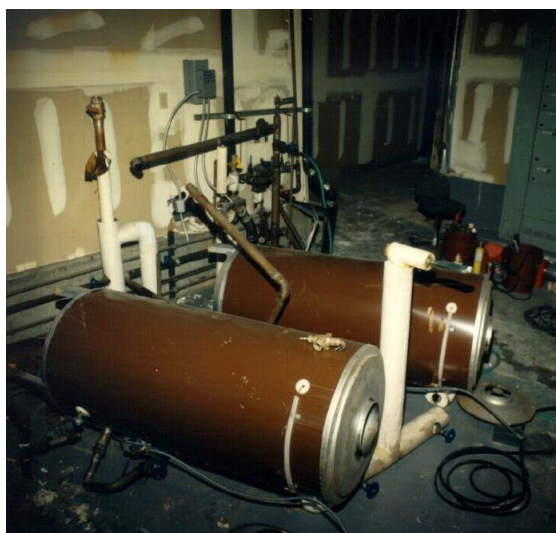
איור 6.4.2.4-1 – התהפכות דוד מים לא מעוגן.
