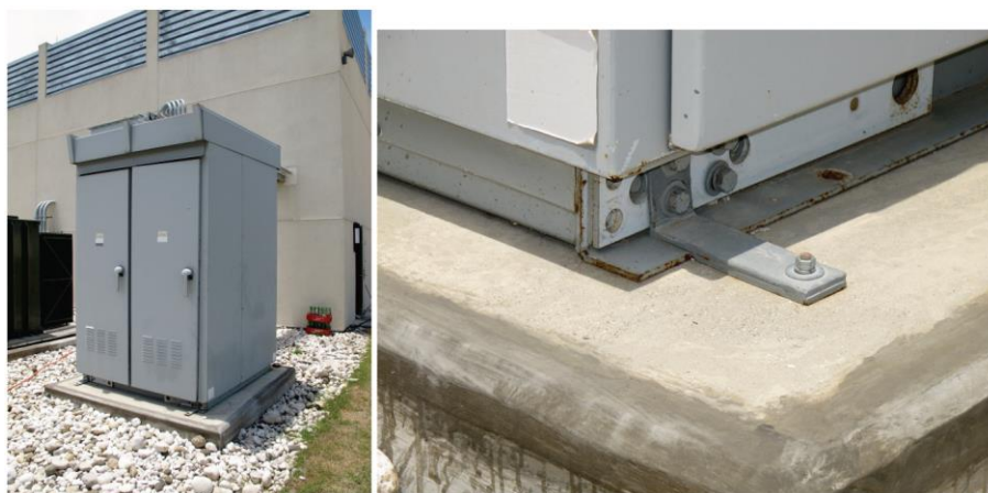
איור 6.4.7.3-4 – ארון חשמל חיצוני למתח נמוך המספק כוח חיוני למתקן חשוב. שימו לב כי הציוד מעוגן סיסמית באמצעות חיבורים קשיחים ארוכים המוברגים למסגרת הציוד ולפלטת הבסיס. התמונה צולמה לאחר רעידת אדמה.
