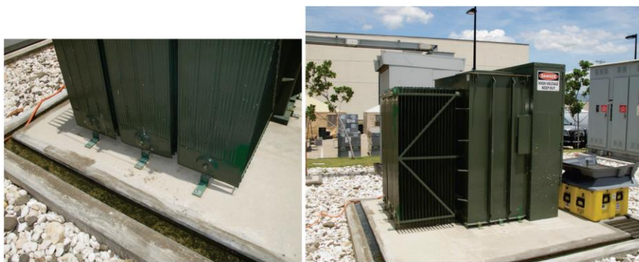
איור 6.4.7.3-5 – שני שמן חיצוני הממיר מתח עבור מתקן חשוב. שימו לב לרכיבים האלכסוניים על המצנן במטרה למזער את ההעמסה הדינאמית על מיכל הנוזלים המכיל מספר חיבורים מרותכים.
