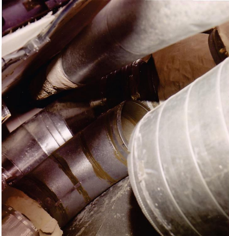
איור 6.4.6.1-1 – תעלה לא מעוגנת שהתפרקה לחלקים.
