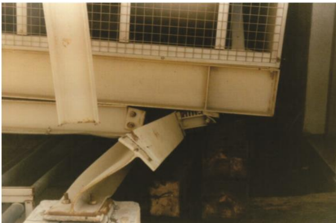
איור 3-6.4.1.3-3 - כשל במערכת תמיכה שלמה הכוללת מבודדי ויברציה.
