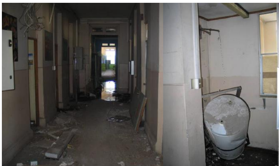
איור 6.4.2.4-2 – נזקים בבית חולים לאחר דליפה מדוד מים שלא היה מעוגן.
