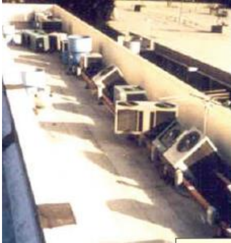
איור 6.4.1.4-2 – התהפכות של מעבי מזגנים שלא עוגנו כראוי לגג.
