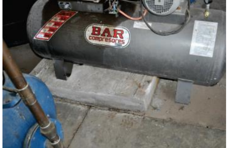
איור 6.4.1.4-1 – החלקה של הקומפרסור ונפילה מבסיסו עקב עיגון לא תקני.
