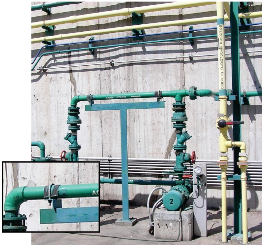
איור 6.4.3.5-1 – הזזות אופקיות של צינור עם תמיכה, ניתן לראות שבורג U לא סיפק קיבוע למרות הוספת פד להגברת מקדם החיכוך בין הצינור לבורג.
