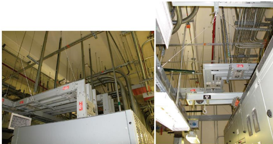
איור 6.4.7.3-3 – מערכת מתח גבוה המעבירה כוח מגנרטור ארון חשמל למתקן. שימו לב לעיגונים בניצב למתלים האנכיים. המערכת תפקדה כראוי בזמן רעידת אדמה.
